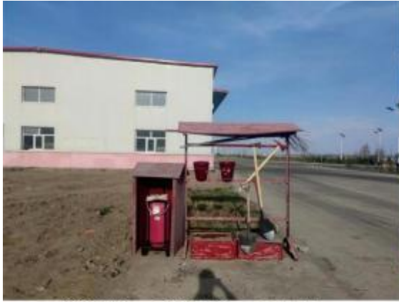
消防锹、消防桶、灭火器
